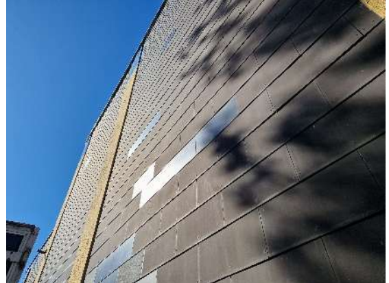
2. Gebäudehinterseite mit ungeeignetem Material ohne ausreichende Spalten schließen pot. Habitatstrukturen am Gebäude aus.
