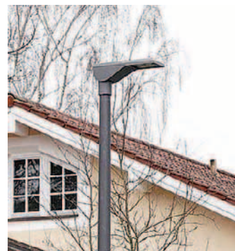
Eine umgebaute Leuchte in der Falkenstraße. Foto: MO
