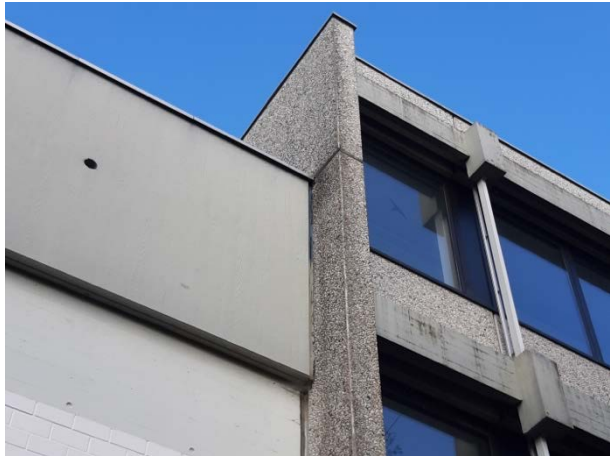
Abb. 6: Südliche Fassade des Bestandsgebäudes mit einem Einflugloch links und Spalten über den Fenstern
