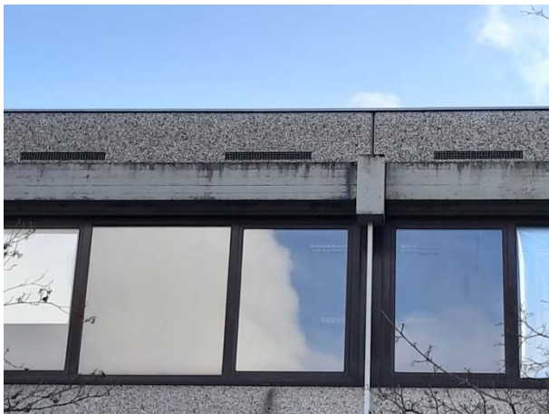
Abb. 18: Einflugslöcher über den Fenstern am bestehenden Bürogebäude
