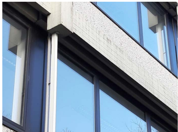
Abb. 7: Detailaufnahme Spalte über Fenster am Bestandsgebäude
